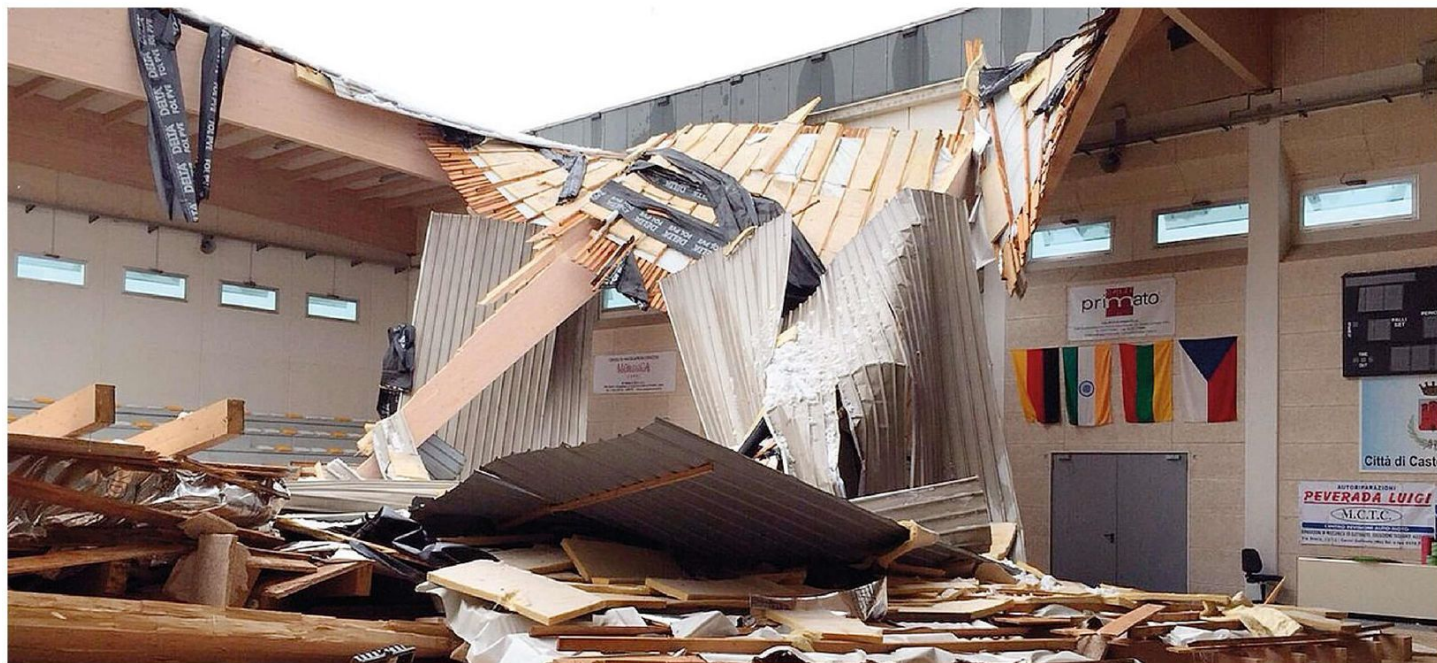
Il tetto crollato del palasport di Castel Goffredo. La struttura, inaugurata nel 2008, non ha retto al peso della neve caduta nella notte tra giovedì e venerdì. Ora un'inchiesta dovrà far luce su quanto avvenuto ieri mattina
